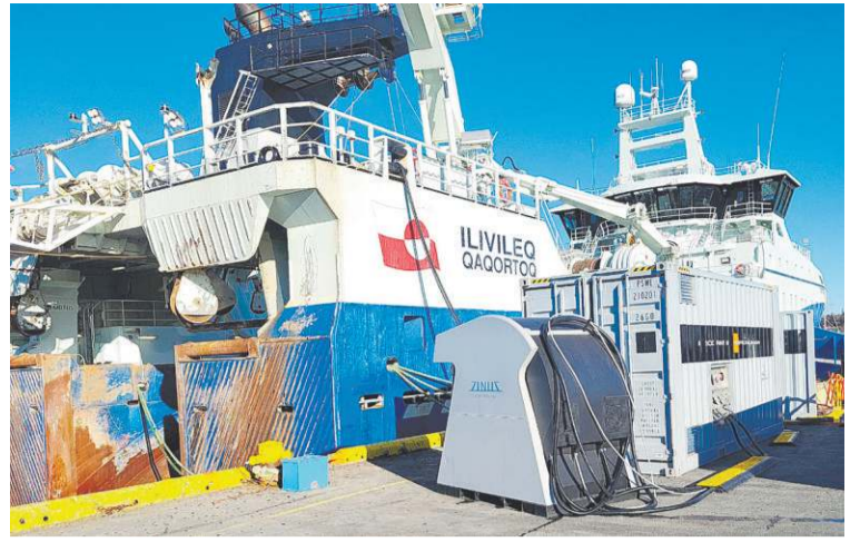
■ Grænlenstur togari tengdur við rafmagn á Hvalleyrabakka. Tugir skipa hafa nú verið tengd við rafmagn í Hafnarfirði og er nýbyrjað að tengja við Miðbakka í Reykjavík.
