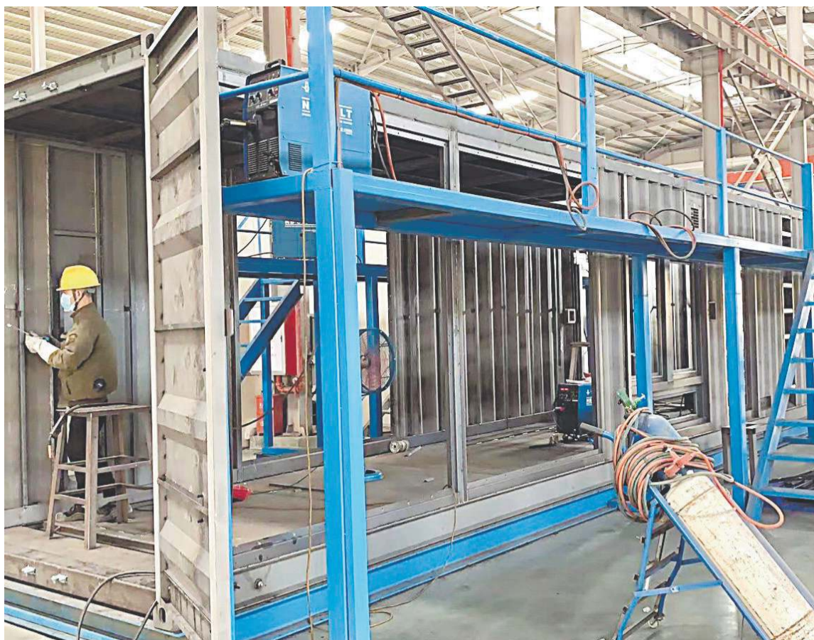
■ Uppsetning á gámi fyrir varaafstöð. Vélin er af gerðinni Mitsubishi S16R-PTA2 1750 kVA PRP.
