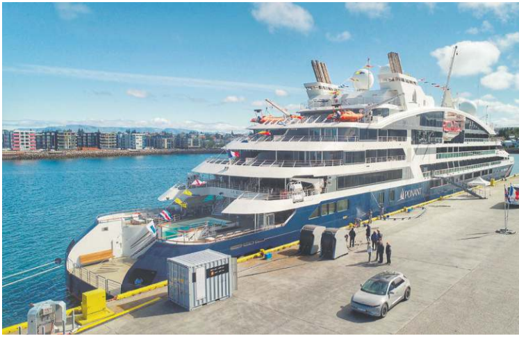
■ Fyrsta háspennutenging við farþegaskip hérlendis var tekin í notkun á sjómannadaginn 2022 þegar farþegaskipið Le Bellot var tengt við háspennukerfið á Suðurbakka í Hafnarfjarðarhöfn.
