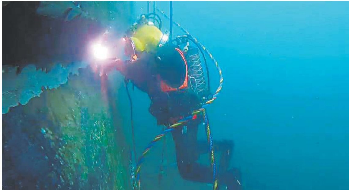
■ Köfunarþjónustan hefur náð góðum árangri í viðgerðum á tærðum stálpiljum hafna. Viðgerðarlausn fyrirtækisins sparar hafnasjóðum umtalsverða fjármuni.
